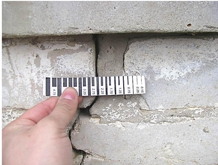
Фото 7. Определение ширины раскрытия трещин в стене здания
