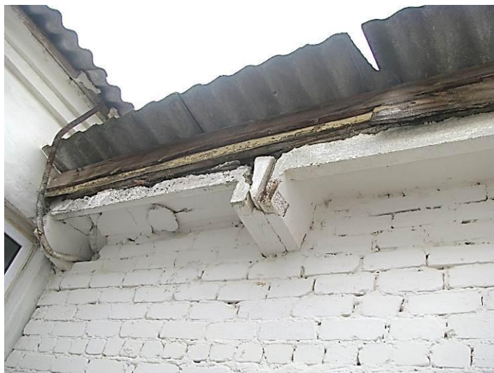
Фото 8. Фиксация дефектов и повреждений покрытия
